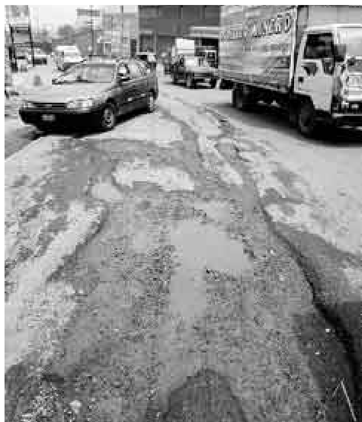
CRÁTERES. La pista de la avenida Las Torres, que conecta la autopista con la Carretera Central, está en pésimas condiciones y llena de huecos.
